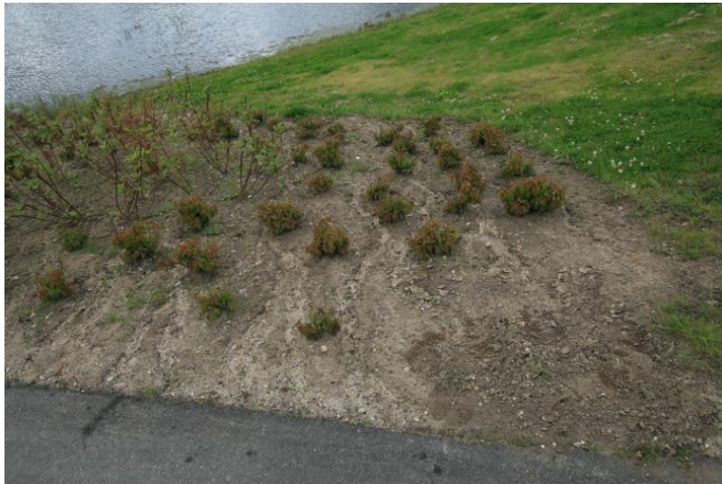
Figur 25. Skylleskader/erosion i et nyanlæg
