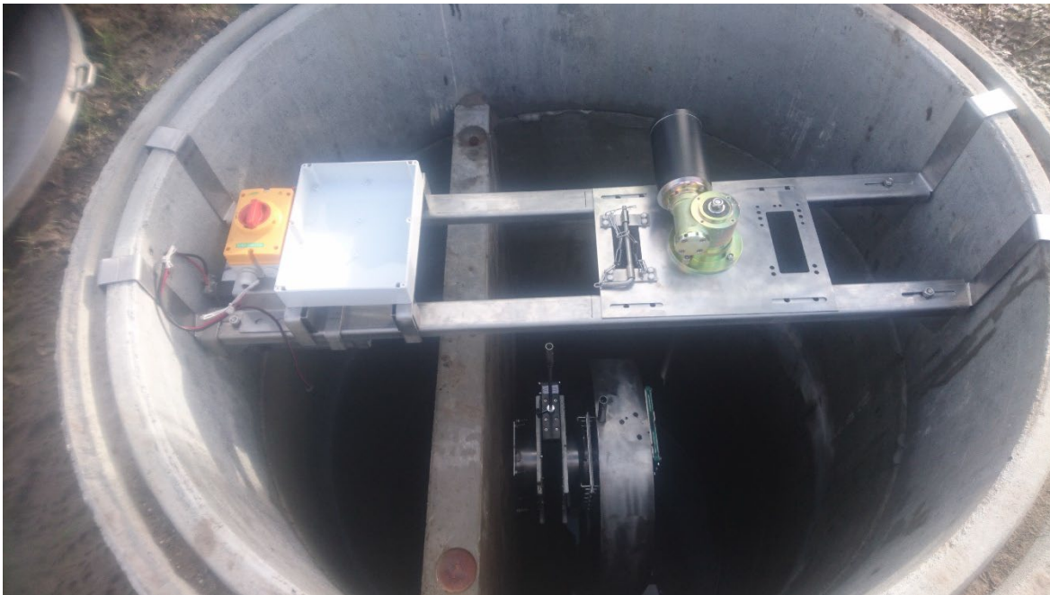
Figur 5-4 Udløbsbrønden i Voldum i forbindelse med opsætningen af ReLeVand-bremsen (inden ledninger mm. blev trukket) – fra venstre ses nødstopkontakten, kassen som indeholder regulatoren, overløbskanten, ReLeVand-bremsen, og motoren. Under nødstoppet er monteret et batteri.
