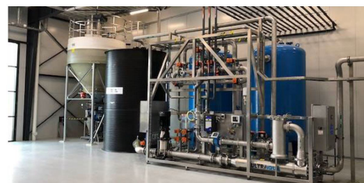
Figur 4 Desinfektionstrin på behandlingsanlægget på bryggeriet.
