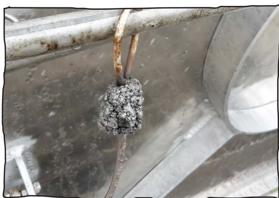
Figur 13: Omfattende korrosion af alu-plumbe
