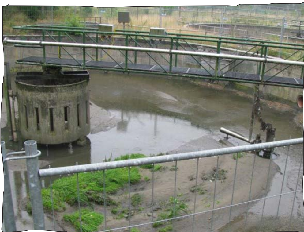
Figur 7: Sediment i bassin, hvor der er risiko for svovlbrintefrigivelse ved berøring
