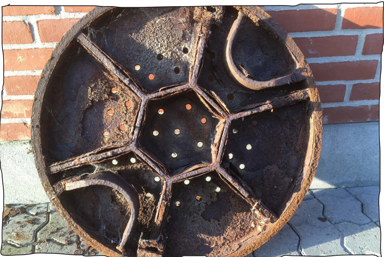
Figur 2 Kørebandedæksel som er voldsomt korroderet af svovlbriente. Foto Hedensted Spildevand.
