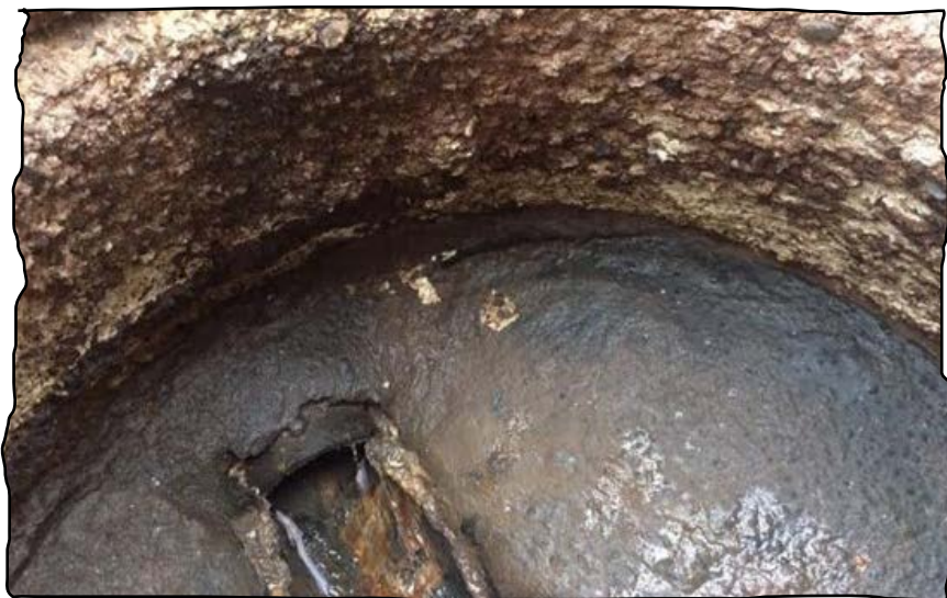
Figur 3 Betonbrønd med omfattende korrosionsskader (Foto Asbjørn ??)
