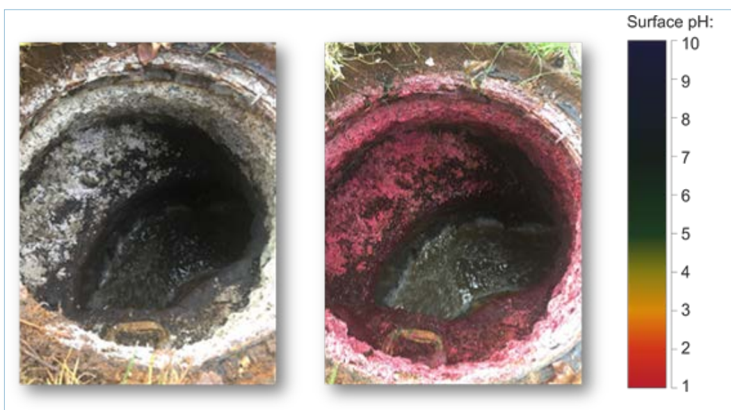
Figur 17: Betonbrønd før og efter påsprøjtning af pH-indikatorvæske. Overfladens pH er lavere end 2 og tydeligt syrepåvirket.
