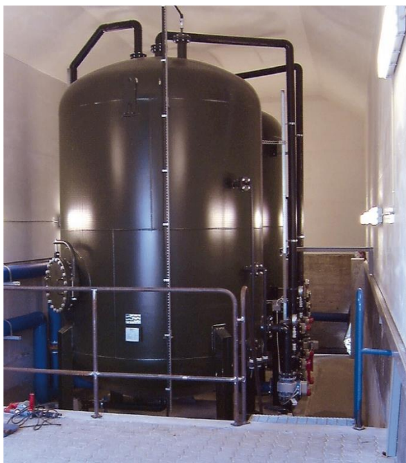
Figur 1. Aktive kulfiltre (GAC-filtre) på Hvidovre Vandværk, etableret i 1997.
